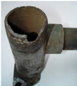
Schadhaftes Wasserrohr am B-Motor
